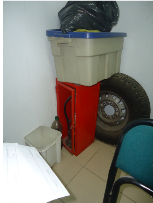
Fotografía N° 106. Extintor (C. La Ofelia)
