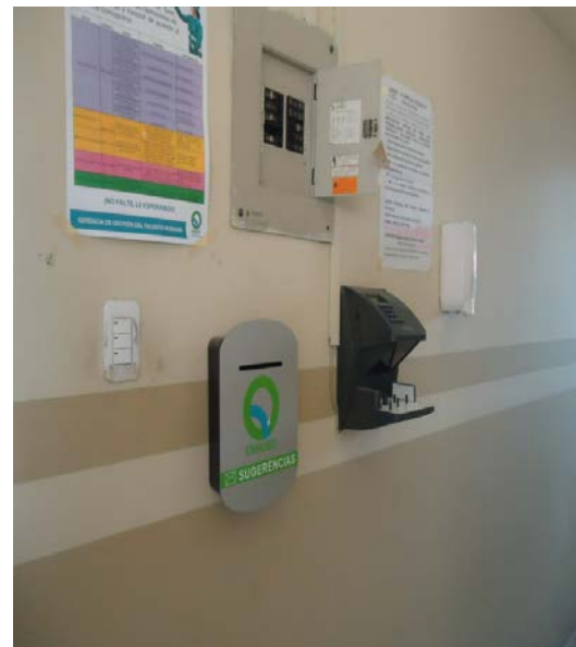
Fotografía N° 148. Caja de brakers, dispositivo para registro de asistencia (C. Zámbez)
