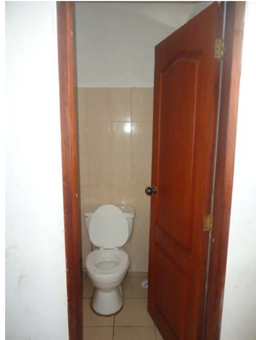
Fotografía N° 114. Batería sanitaria (C. La Ofelia)
