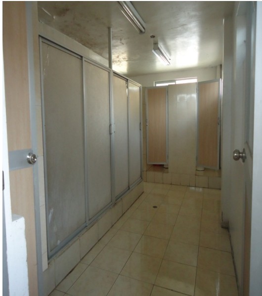
Fotografía N° 59. Baños y duchas de los vestidores para ayudantes de recolección (C.O. La Forestal)
