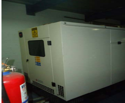
Fotografía 2: Generador eléctrico C.O. La Occidental
