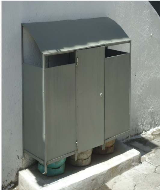
Fotografía N° 63. Almacenamiento de GLP al exterior del edificio principal (C.O. La Forestal)
