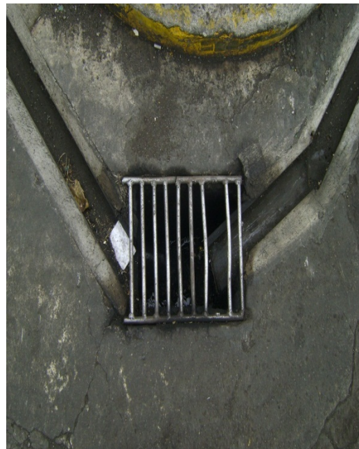
Fotografía N° 42. Canaletas perimetrales en la estación de combustible (C.O. La Occidental)
