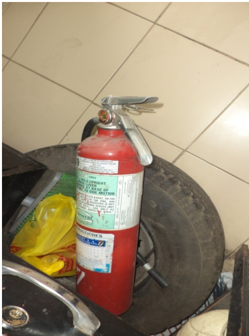
Fotografía N° 119. Extintor (C. La Carolina)
